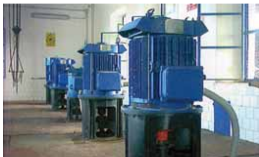
Fig.2. Sala pompe Palude Lauro (agro di Lesina) - motori elettrici ad "inverter".
